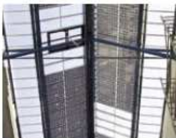
Les capteurs photovoltaïques sont intégrés à la verrière de la galerie de distribution d'une résidence HLM. L'Isle d'Abeau (Isère) © Photowatt
